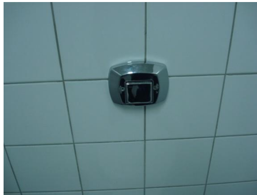
Figura 4. Sistema de descarga. Fonte: Autoria própria, 2014.
