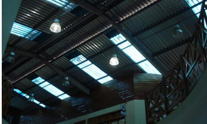
Figura 3. Sistema alternativo de iluminação. Fonte: Autoria própria, 2014.
