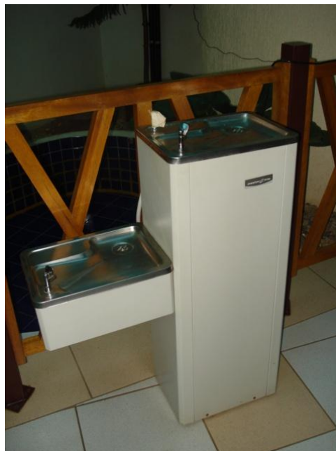
Figura 11. Dispositivo de Acessibilidade- b. Fonte: Autoria própria, 2014.
