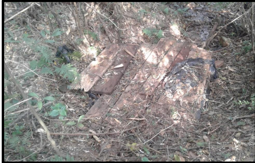
Figura 10 - SAI próxima ao nível do solo e com tampa inadequada
