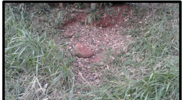
Figura 6 - SAI com tampa inadequada e no nível do solo
