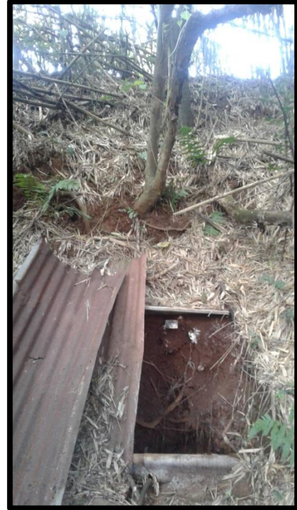
Figura 8 - Tampa da SAI inadequada
