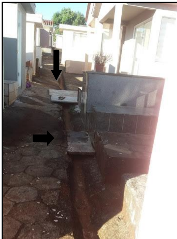
Figura 4 - Estruturas de drenagem pluvial do Cemitério Municipal Padre Artur Vangeel
