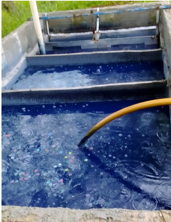
Figura 9: Tanque de decantação
