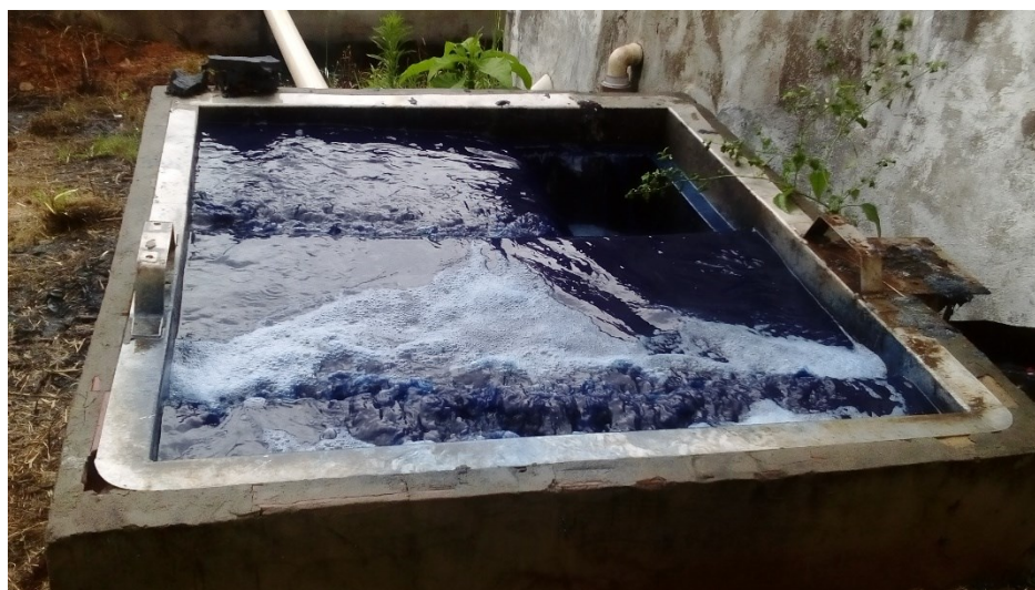
Figura 7: Segundo tanque de despejo do efluente.
