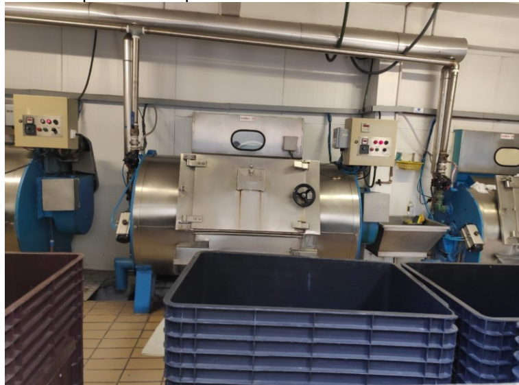
Figura 2 - Área em que estão dispostas as lavadoras industriais da lavanderia
