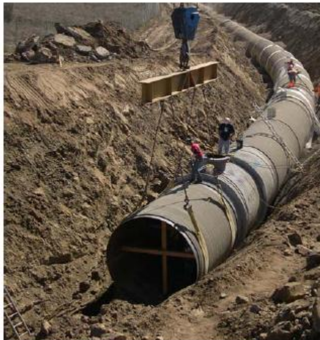
Figura 3 – Tubulação para transporte de fluido suportada pelo solo. Fonte: American Iron and Steel Institute, 2007, p.25.
