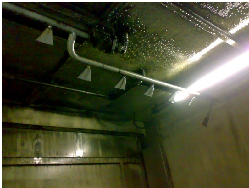
Figura 35 - Tubulação de fluido refrigerante
