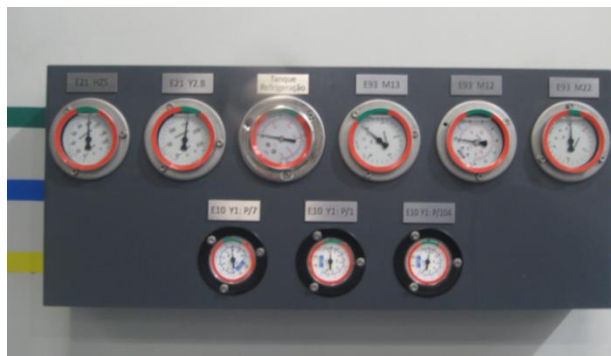
Figura 42 - Central de manômetros
