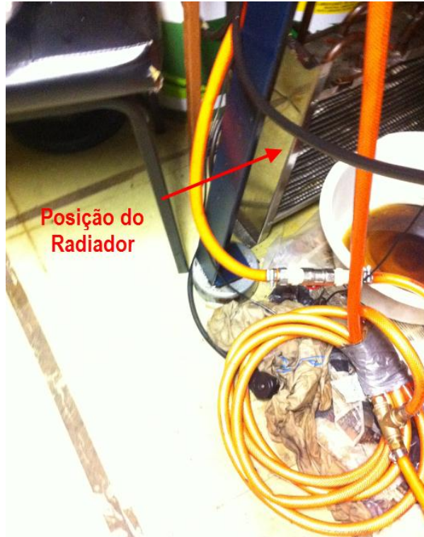
Figura 8 - Detalhes das Instalações do Radiador do Equipamento da UTFPR
