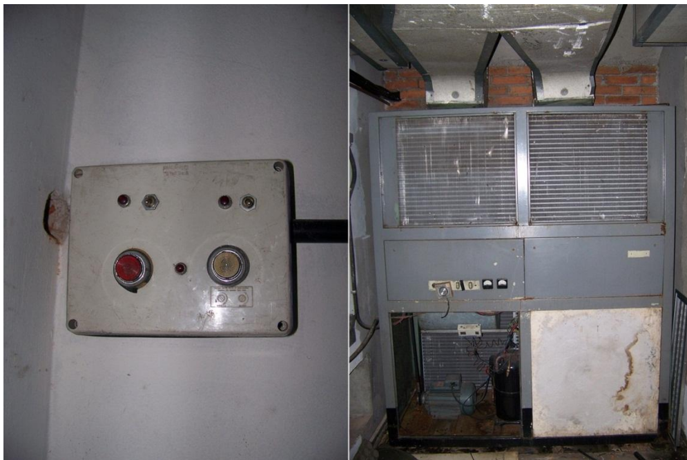
Figura 43 – Ar condicionado da sala I-002
