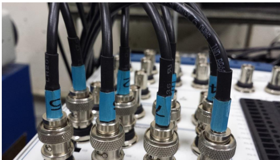
Figura 30 – Conexões dos cabos (1 a 8) no aqisitor/conversor de sinais Fonte: Autoria Própria.
