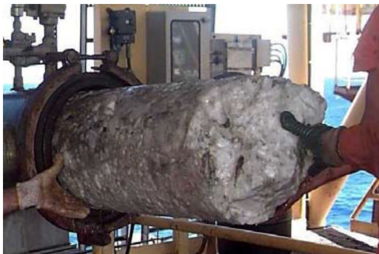
Figura 1.4 – Bloqueio de uma tubulação de extração de petróleo e gás natural por formação de hidratos (Arquivo da Petrobras).
