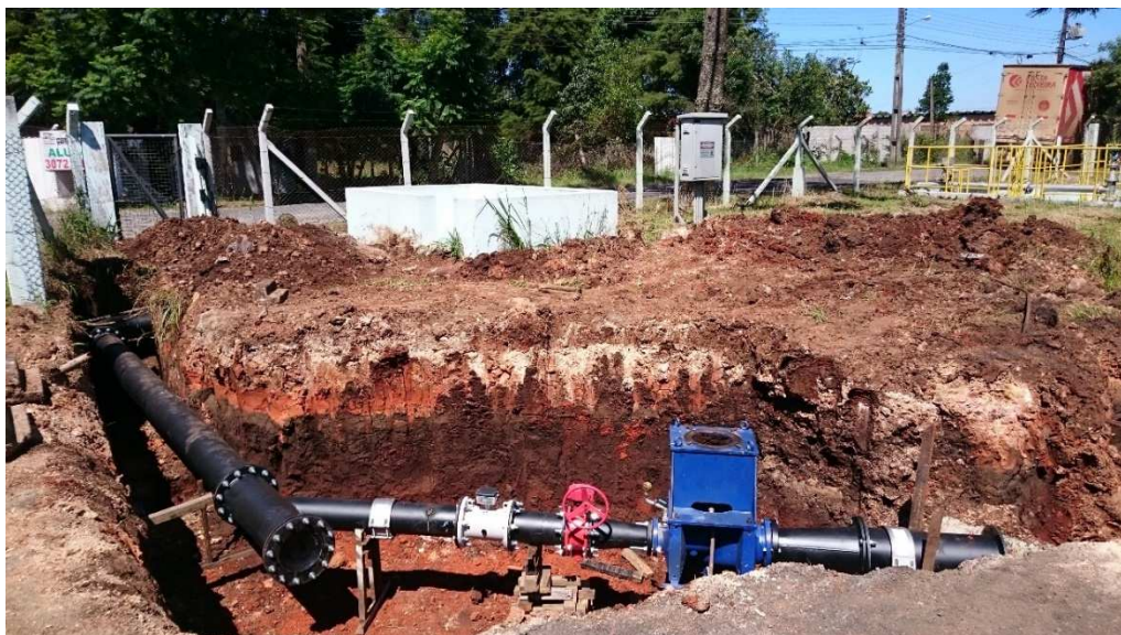
Figura 64: Foto da escavação, remoção de terra e acomodação do sistema hidráulico. Fonte: Os autores, 2016.
