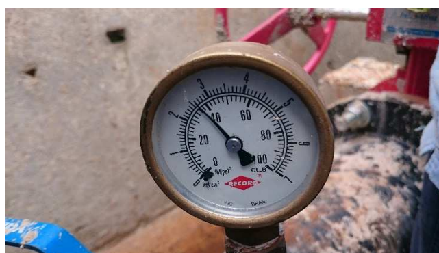
Figura 73: Foto do manômetro instalado na entrada da BFT. Fonte: Os autores, 2016.
