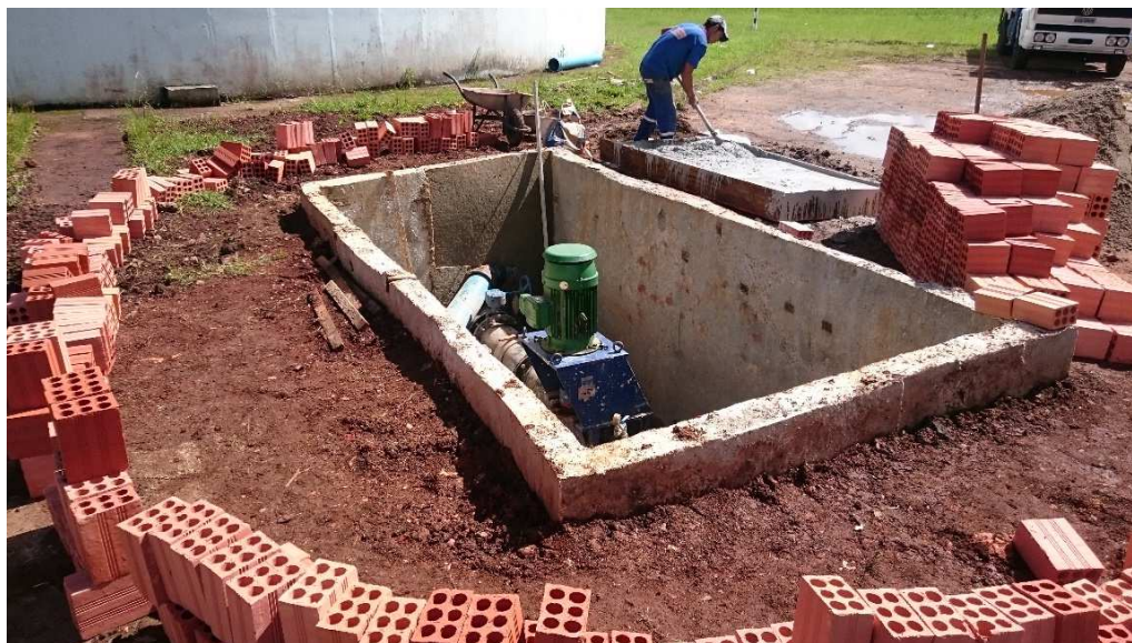
Figura 66: Foto da caixa com a BFT instalada. Fonte: Os autores, 2016.
