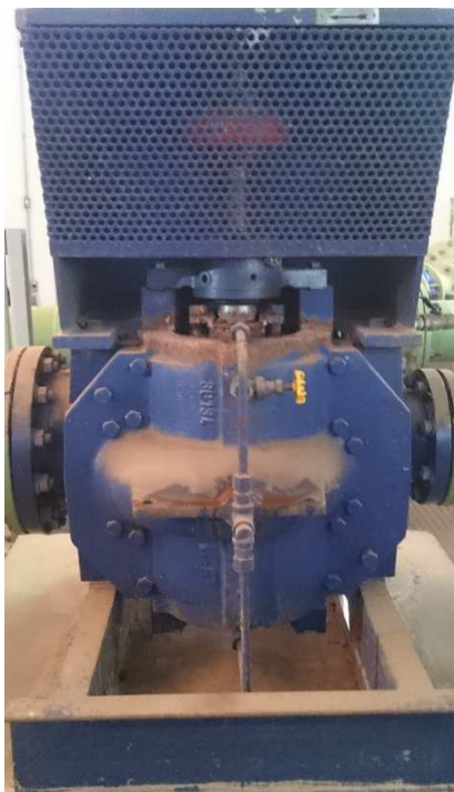
Figura 56: Foto da bomba selecionada. Fonte: Os autores, 2015.
