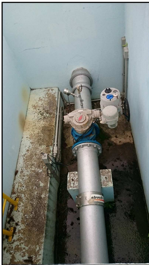
Figura 38: Foto da válvula controladora de vazão do reservatório apoiado São José Aeroporto. Fonte: Os autores, 2015.
