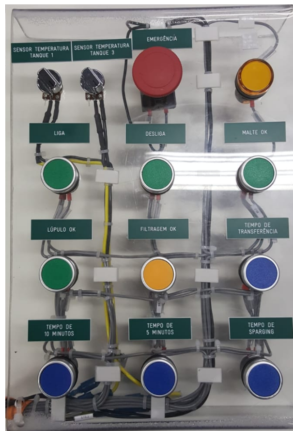
Figura 22: Painel de Comando. Fonte: Autoria Própria.
