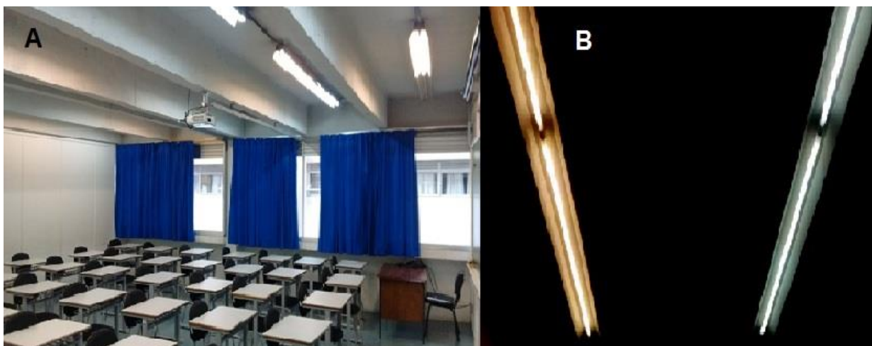
Figura 21 - Item A: Sala de aula A-206 no bloco A, item B: diferença de temperatura de cor na iluminação bloco A.
