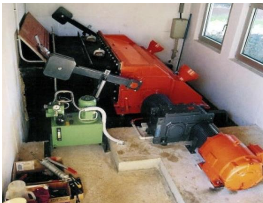
Figura 17 - Aspecto de um grupo gerador com turbina Michell Banki Fonte: GOMES, (2010).
