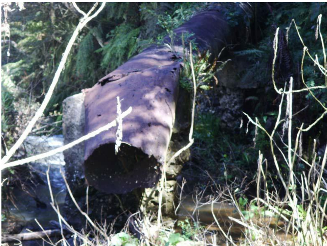
Figura 24: Conduto forçado - MCH Roncador
