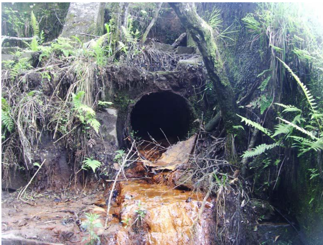
Figura 23:- Tubulação forçada, saída da tomada d'água - MCH Roncador
