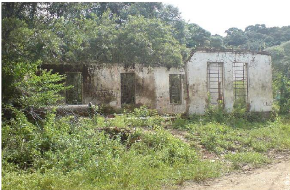
Figura 26: Casa de máquinas - MCH Roncador
