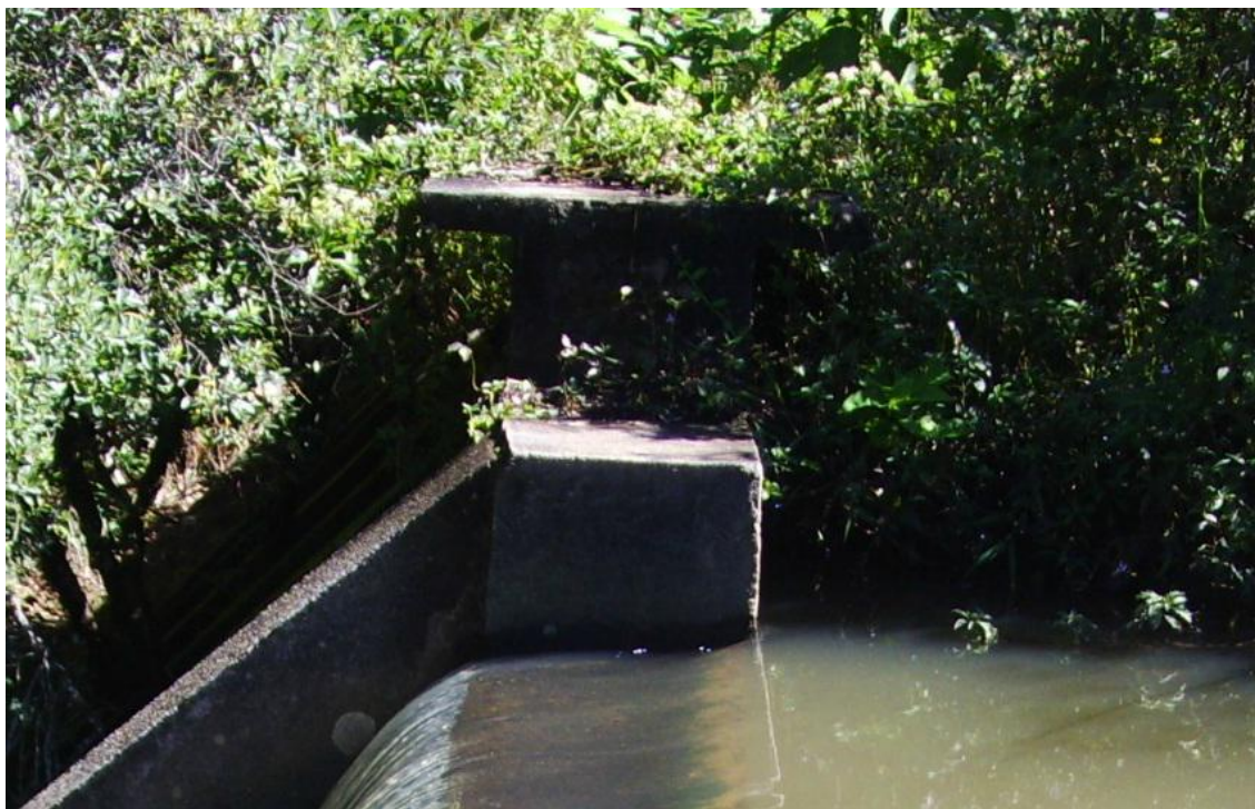
Figura 22: Tomada d'água MCH Roncador
