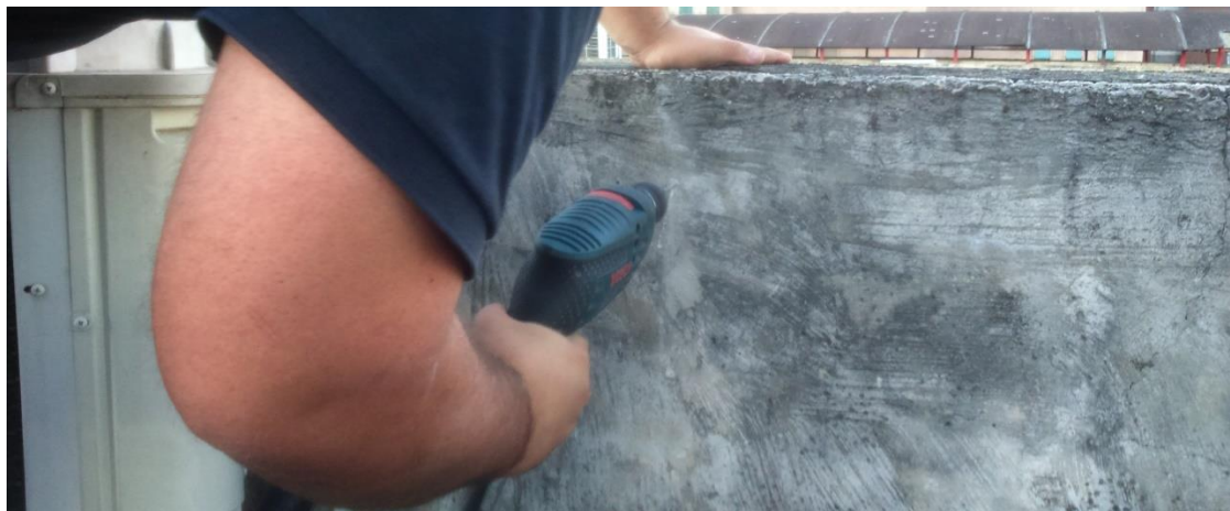
Figura 31 Confeção dos dois primeiros furos na parede (a) Fonte: Acervo da Autora
