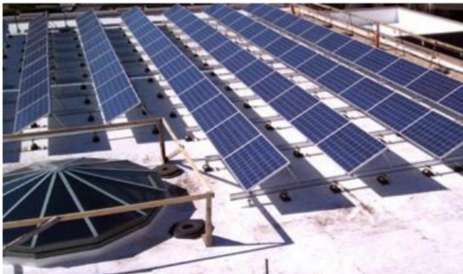
Figura 30 - Suportes dos módulos. Fonte: ABINEE, 2012.
