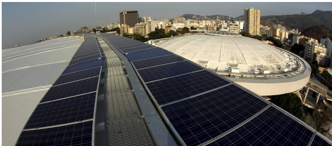
Figura 67 - Módulos fotovoltaicos do novo Maracanã. Fonte: O GLOBO, 2014.
