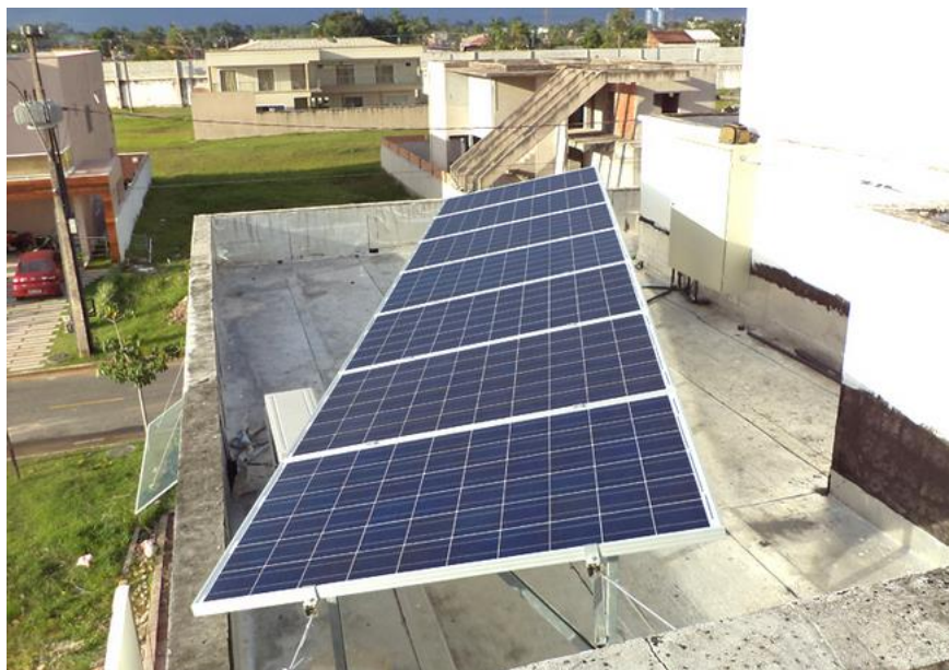
Figura 57 - Painéis na residência de Roberto Chaves Castro. Fonte: SOLAR ENERGY, 2014.
