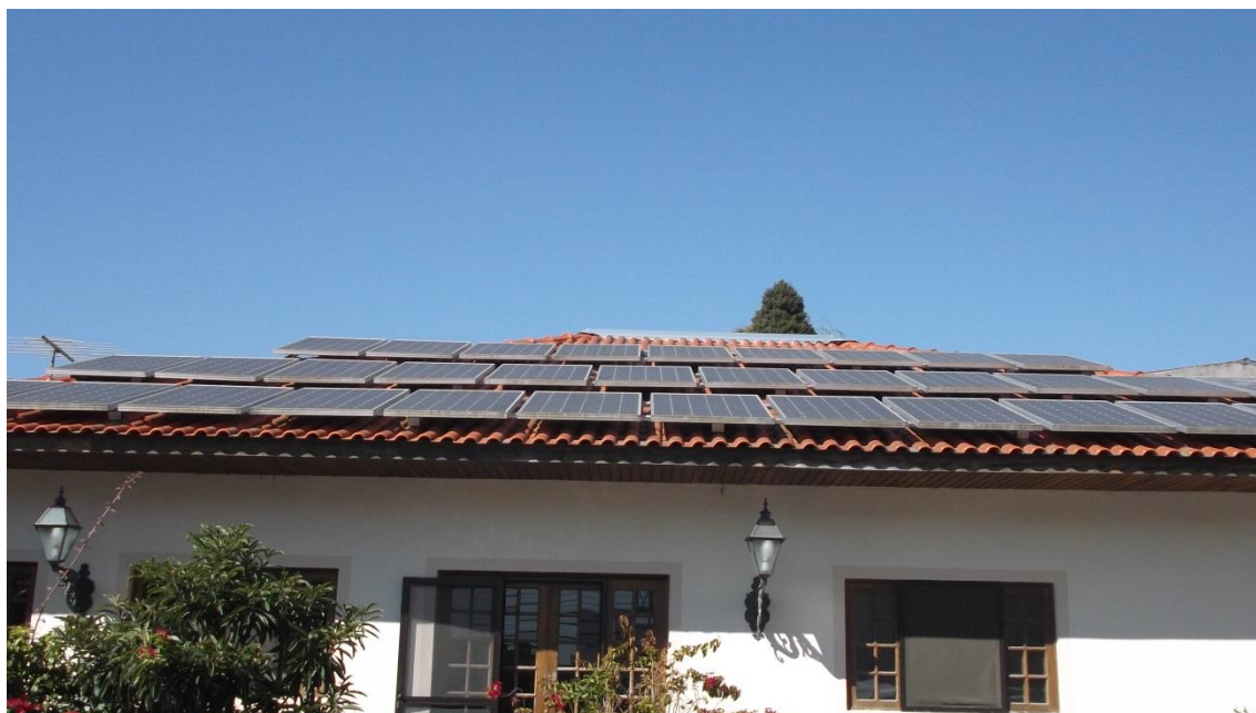
Figura 63 - Módulos fotovoltaicos da empresa ELCO Engenharia LTDA . Fonte: os autores, 2014.
