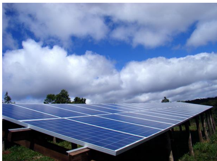
Figura 60 – Instalação Fotovoltaica no SPA Ventura. Fonte: SOLAR ENERGY, 2014.
