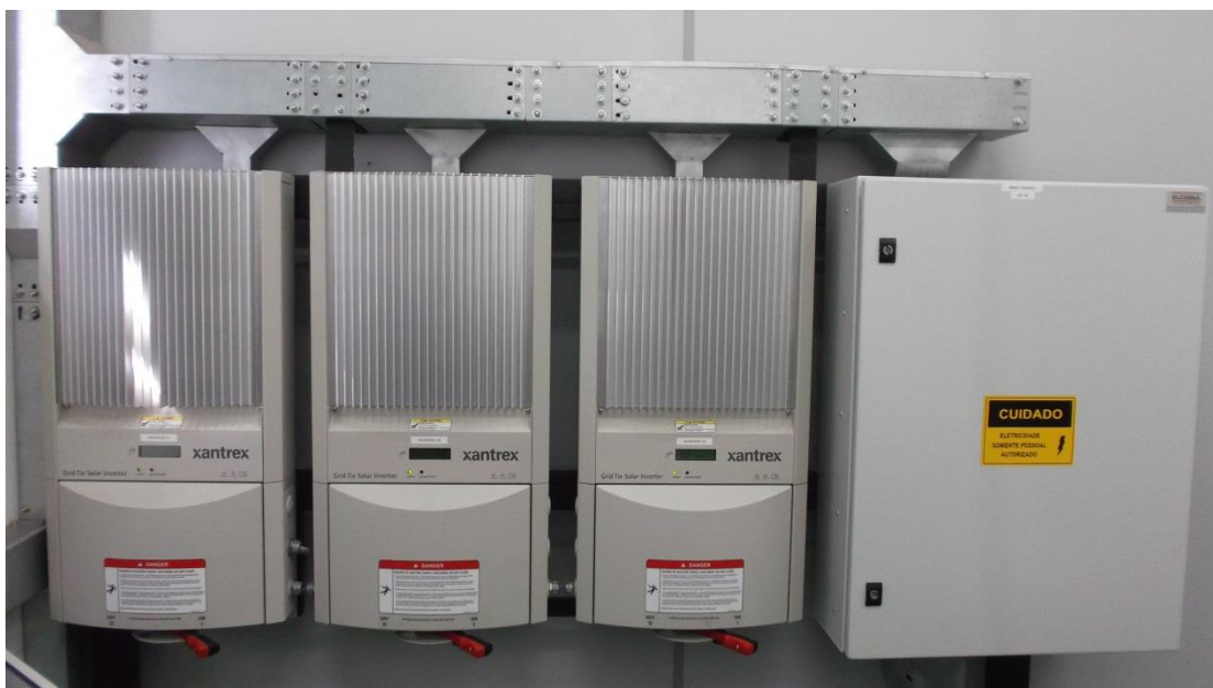
Figura 64 - Inversores do sistema fotovoltaico da empresa ELCO Engenharia LTDA . Fonte: os autores, 2014.
