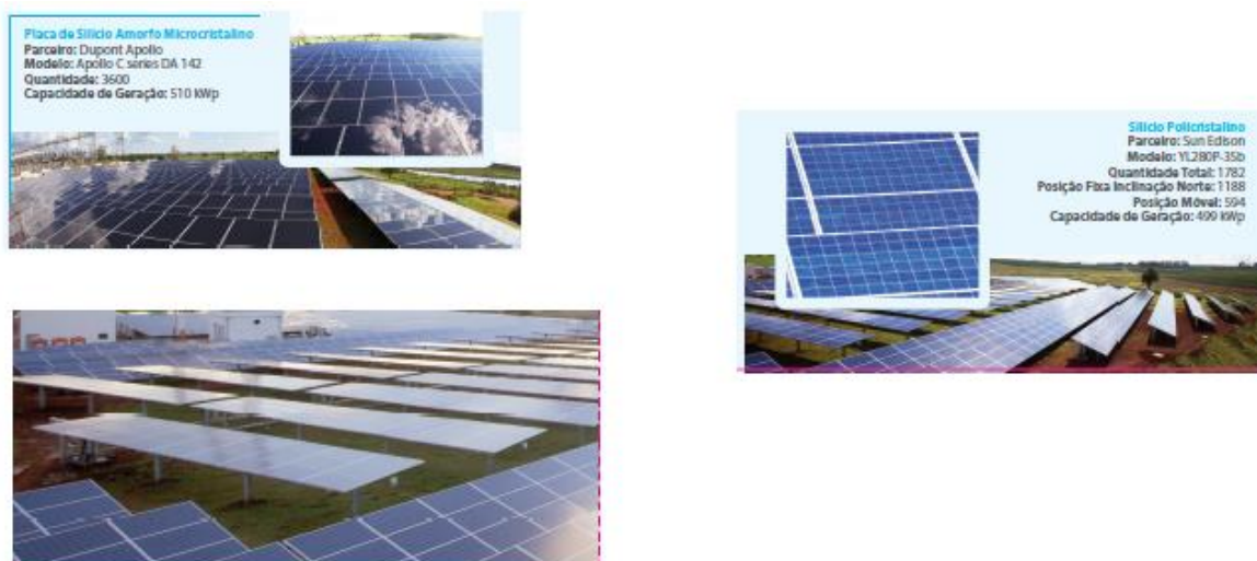
Figura 66 - Usina solar tanquinho.
