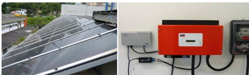
Figura 44 - Módulos fotovoltaicos e inversor atual (SB2500) do LABSOLAR. Fonte: adaptado de URBANETZ JUNIOR, 2010.
