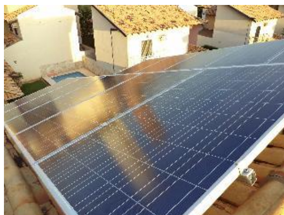
Figura 55 - Detalhe dos painéis fotovoltaicos. Fonte: RICARDO MARCELINO SANTANA , 2014.
