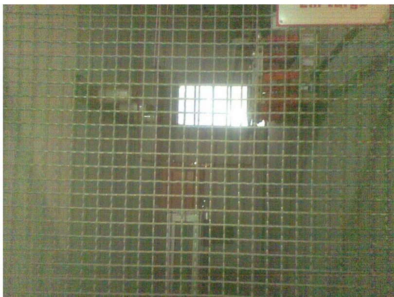
Fotografia 2 – Cubículo de proteção da UTFPR Fonte: Própria
