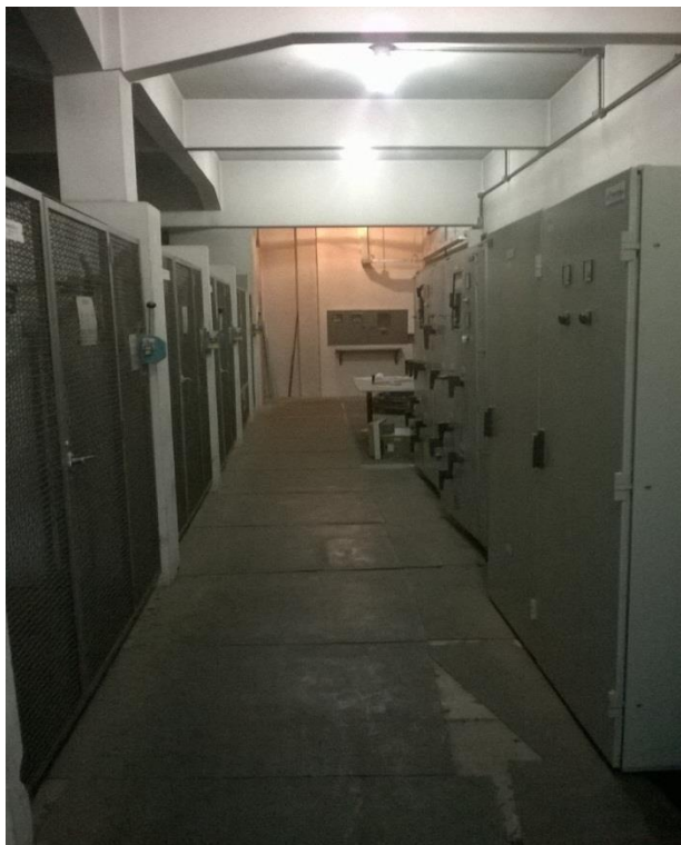
Fotografia 1– Subestação da UTFPR Fonte: Própria
