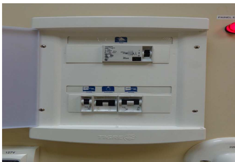
Figura 9: Quadro de Distribuição de Força e Luz (QDFL)
