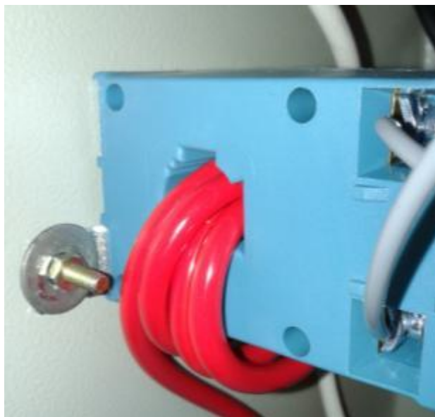
Figura 35 - Detalhe de fixação dos transformadores de corrente Fonte: Autoria própria.
