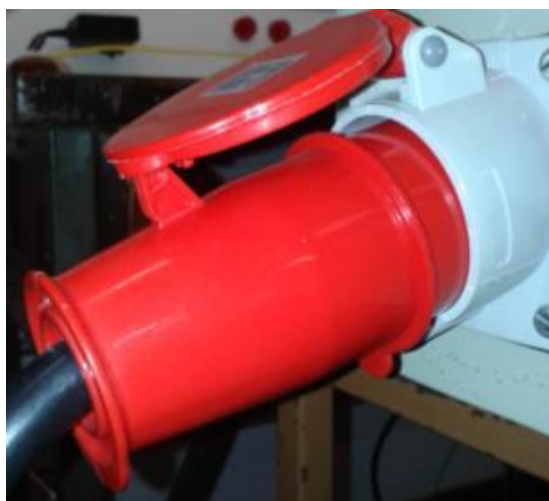
Figura 39 - Detalhes do plug de alimentação externa do painel Fonte: Autoria própria.
