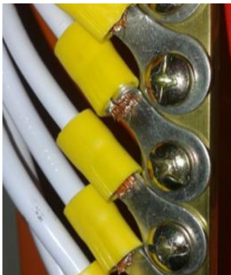
Figura 38 - Detalhe de conexão dos cabos de força ao barramento Fonte: Autoria própria.
