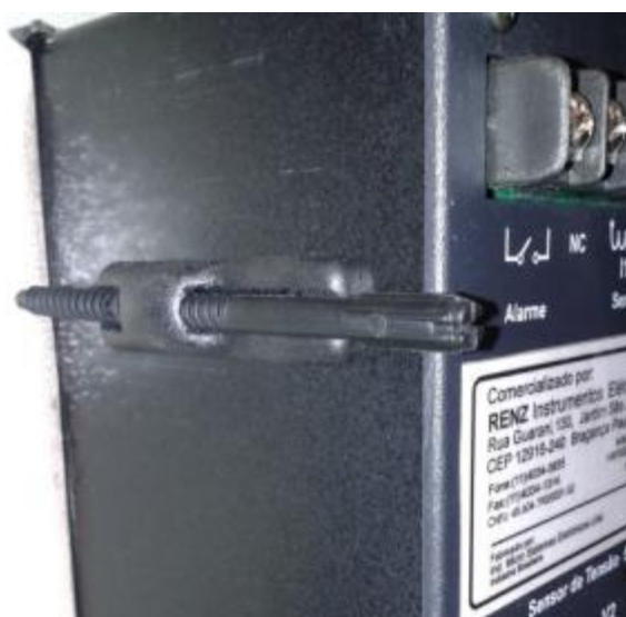
Figura 36 - Detalhe de fixação do medidor eletrônico de energia ao painel Fonte: Autoria própria.
