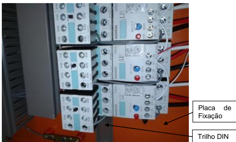
Figura 32 - Detalhe de fixação dos contatores Fonte: Autoria própria.
