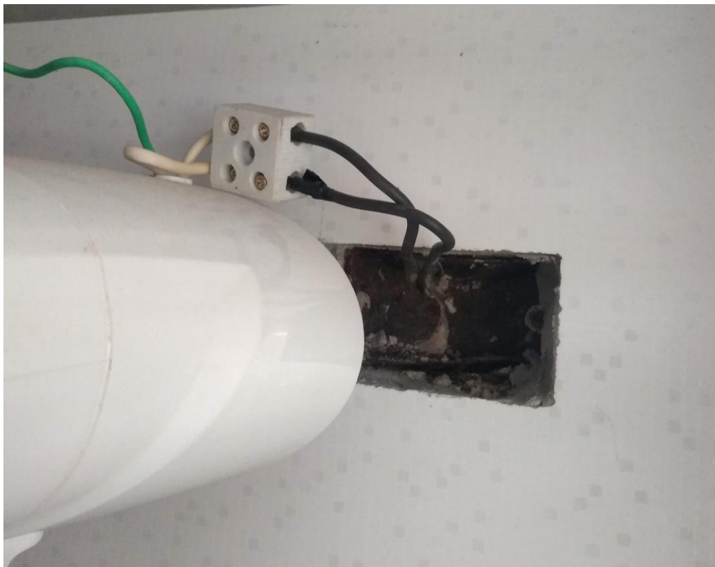
Figura 14 – Conexão do chuveiro do apartamento 2
