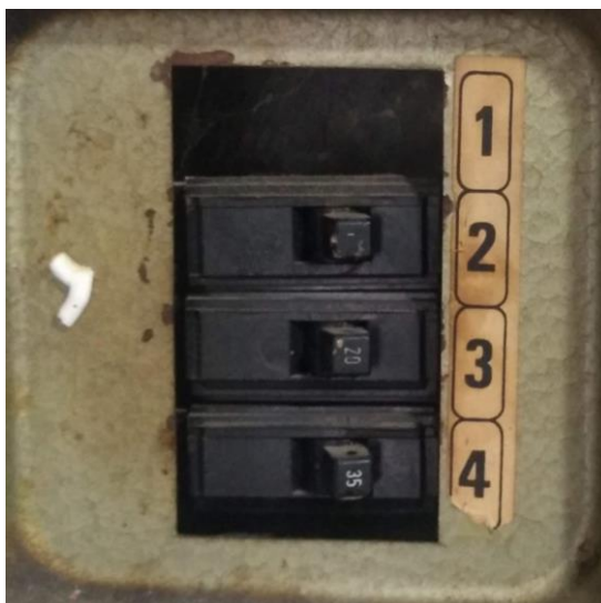
Figura 20 – Circuitos sem identificação
