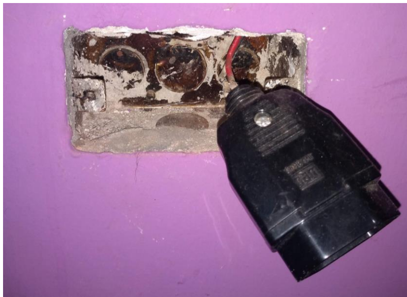
Figura 23 – Tomada improvisada e sem tampa
