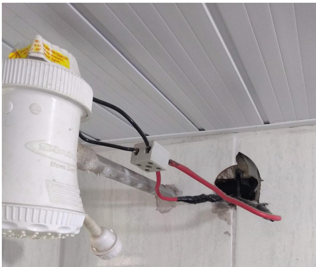
Figura 10 – Conexão do chuveiro do apartamento 1
