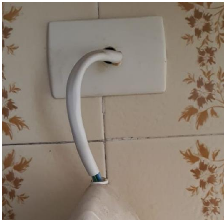
Figura 27 – Conexão do chuveiro do apartamento 22
