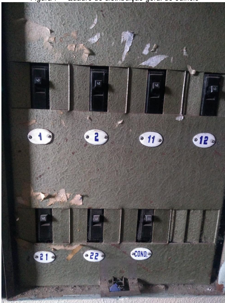
Figura 7 – Quadro de distribuição geral do edifício
