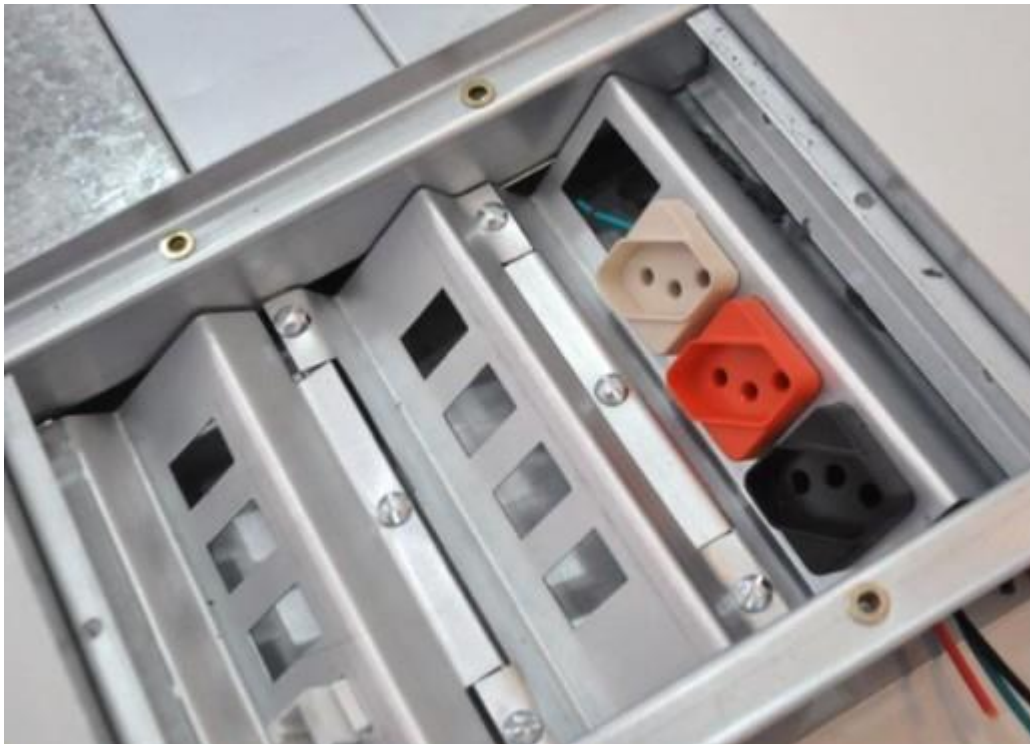
Figura 21 – Vista superior do ponto de rede e tomada.
