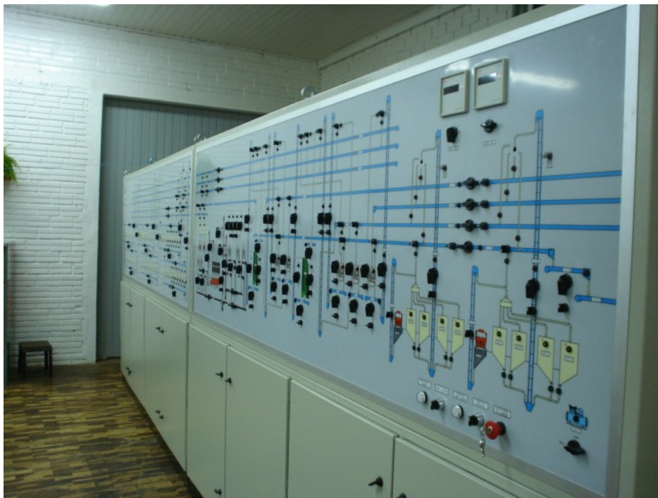
Figura 10 - Sistema Scada telemétrico Fonte: Automações (2011).
