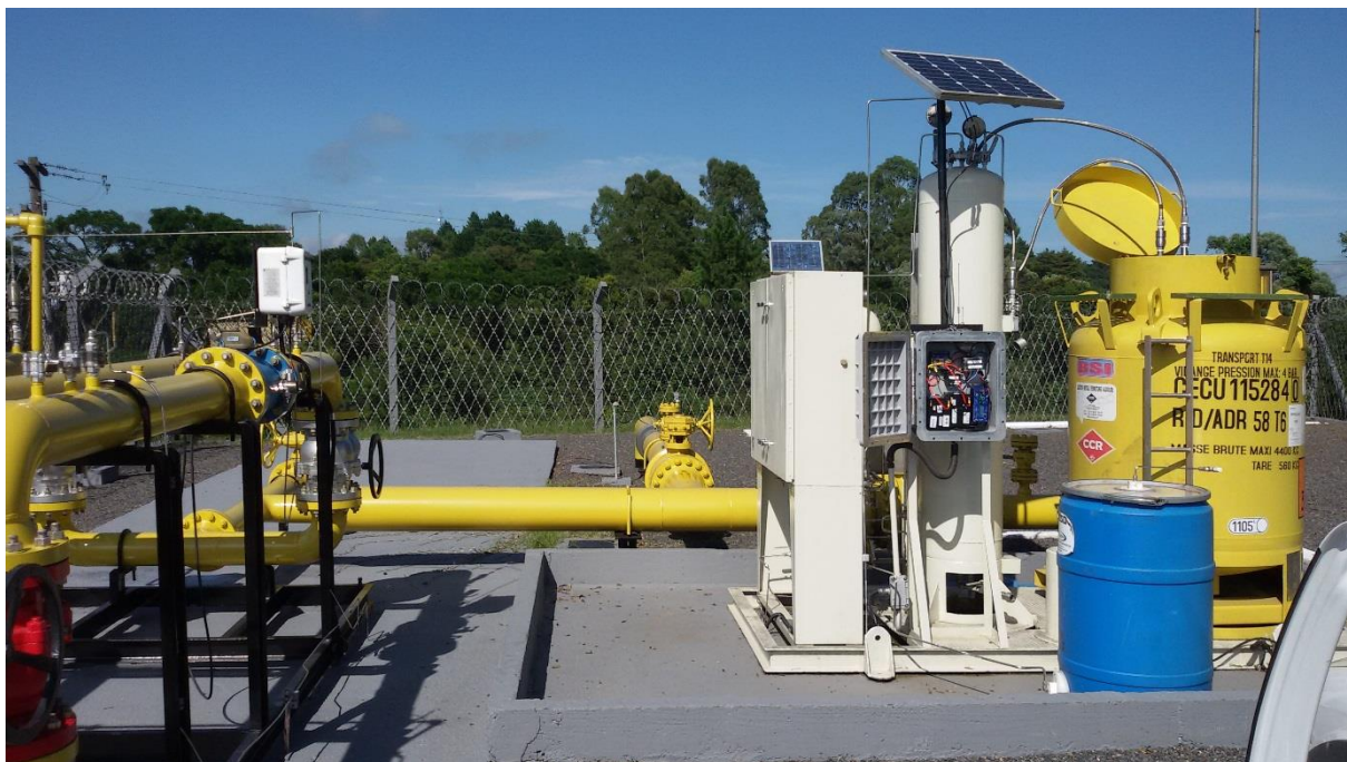
Figura 10 - Conjunto de medição e comunicação City Gate Campo Largo
