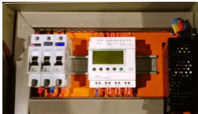
Figura 18 – Montagem contendo o relé programável, a fonte e o disjuntor. Fonte: Autoria Própria
