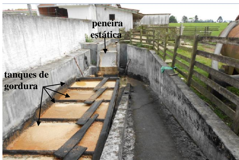
Figura 7 - Peneira estática e tanques de gordura. Fonte: Autoria própria.
