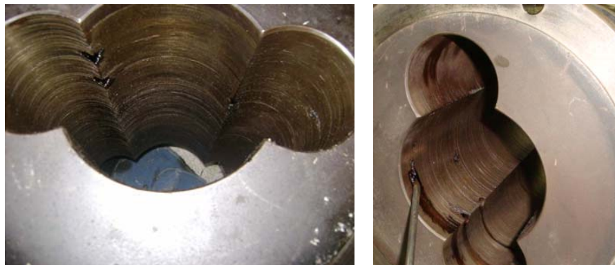
Figura 28 - Corpo da bomba com desgaste excessivo. Fonte: Relatório de manutenção da bomba.
