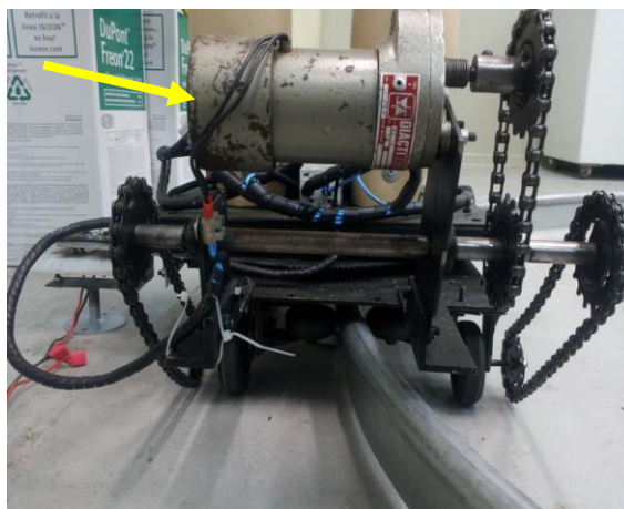
Figura 61 – Motor substituído Fonte: Autoria própria.
