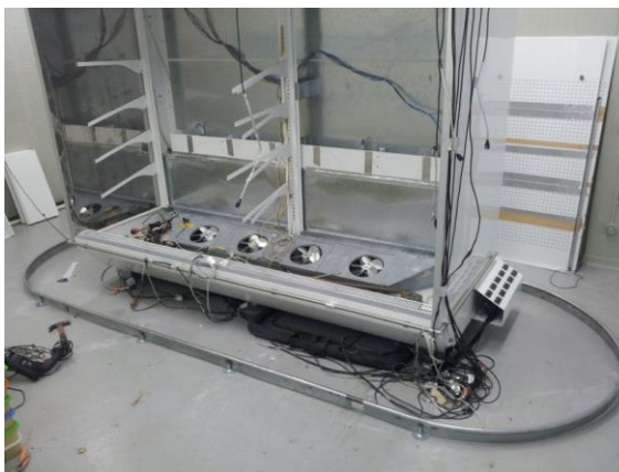
Figura 25 – Instalação no local do cliente Fonte: Autoria própria.
