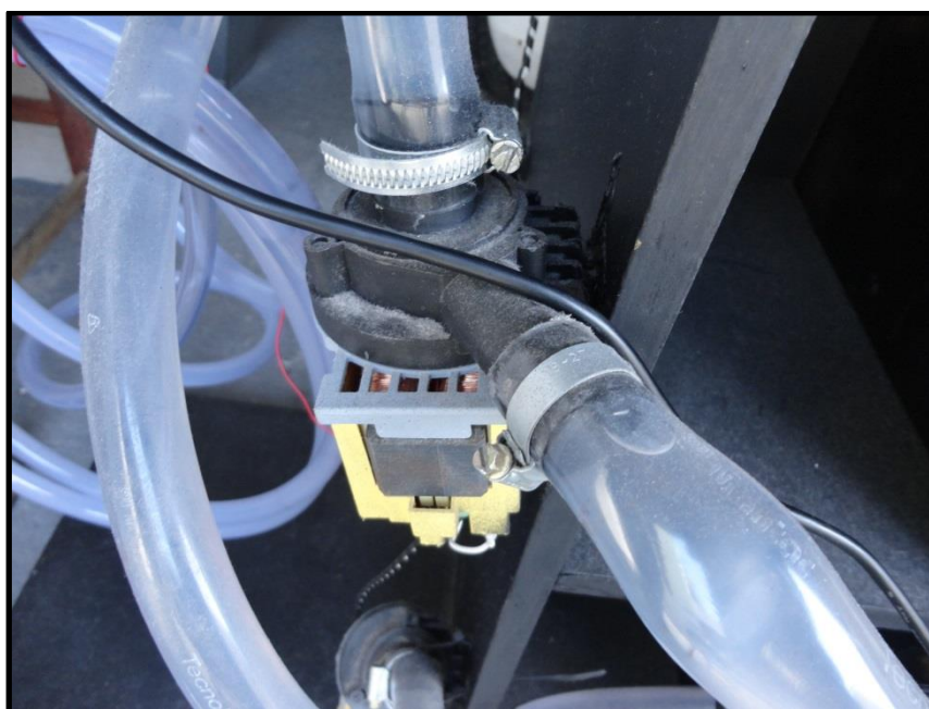
Figura 08: Bomba acionada através de corrente alternada Fonte: A autoria própria.
