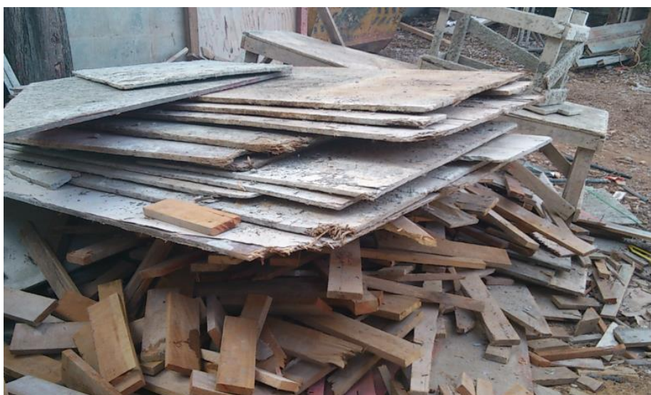
Figura 12: Resíduos provenientes de forma na Obra E.
