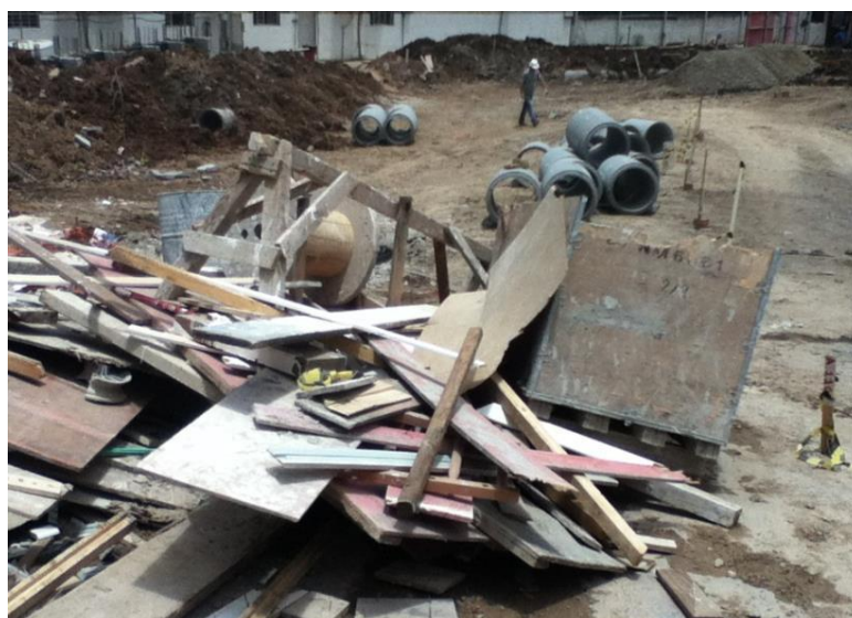
Figura 8: Armazenamento de resíduos na Obra C.
