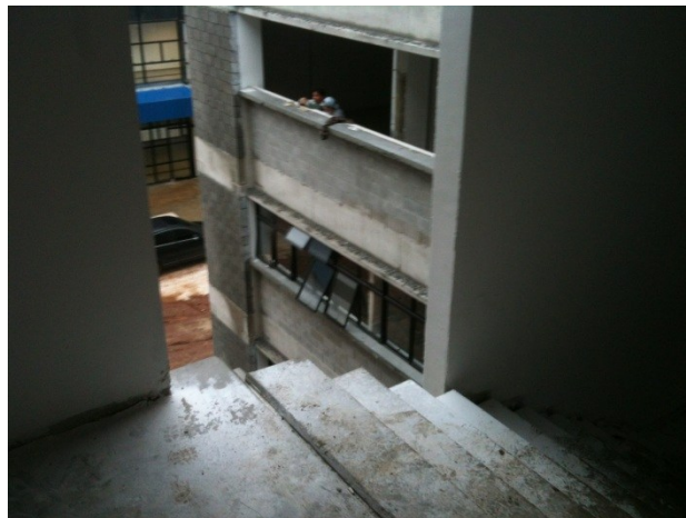
Figura 22 – Abertura desprotegida na escada. Fonte: O autor (2012)
