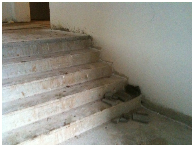
Figura 20 – Detalhe das escadas sem corrimão. Fonte: O autor (2012)
