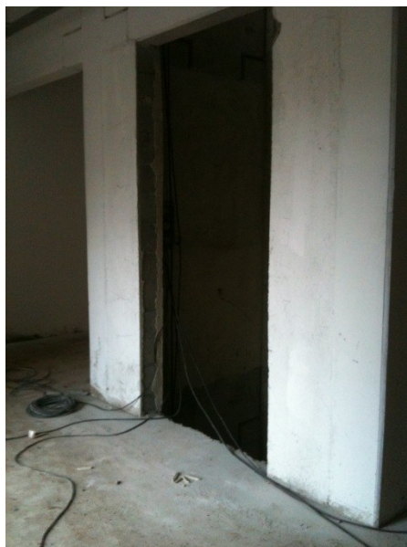
Figura 23 – Abertura reservada para o elevador desprotegida. Fonte: O autor (2012)
