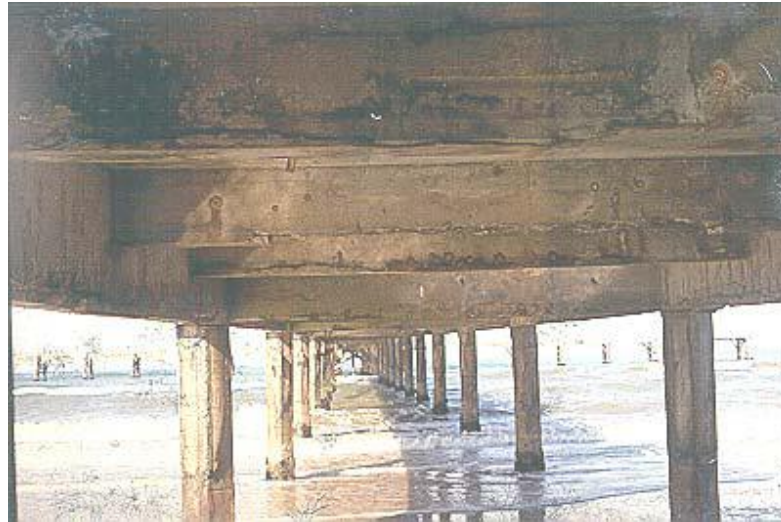
Figura 19: Ataque característico devido à corrosão de armaduras em zona de variação de marés.
