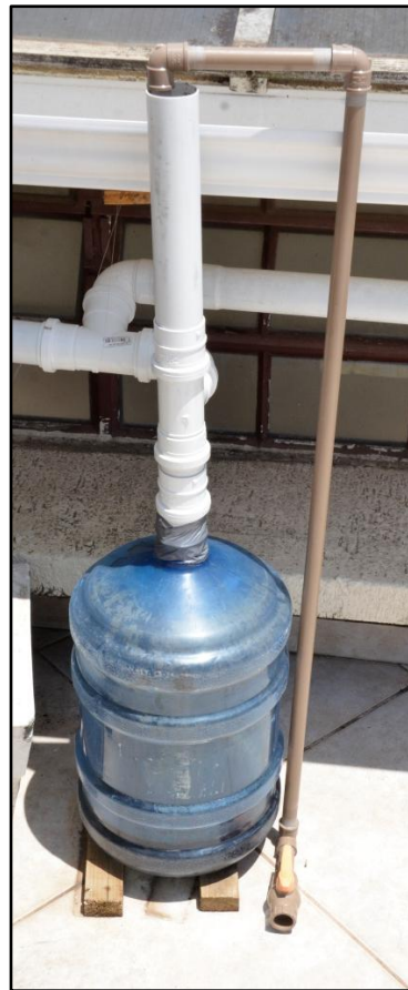
Figura 15 - Utilizando o sifão para esvaziar o separador
