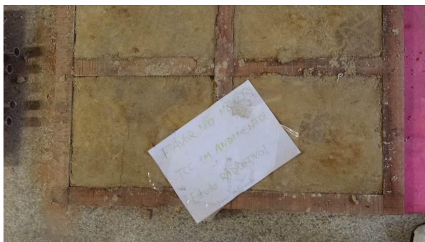
Figura 25 - Placa pré-moldada fissurada
