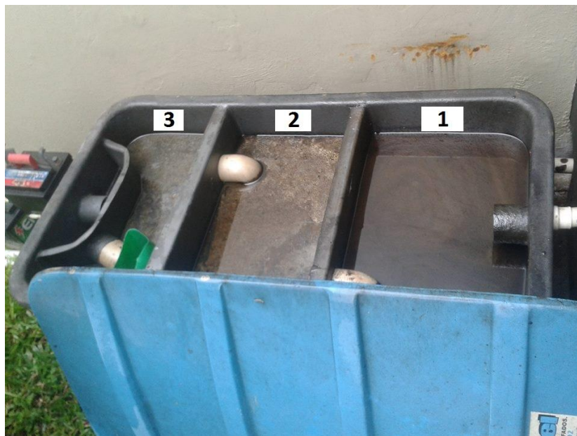
Figura 10 - Caixa separadora de água e óleo utilizada na oficina mecânica.
