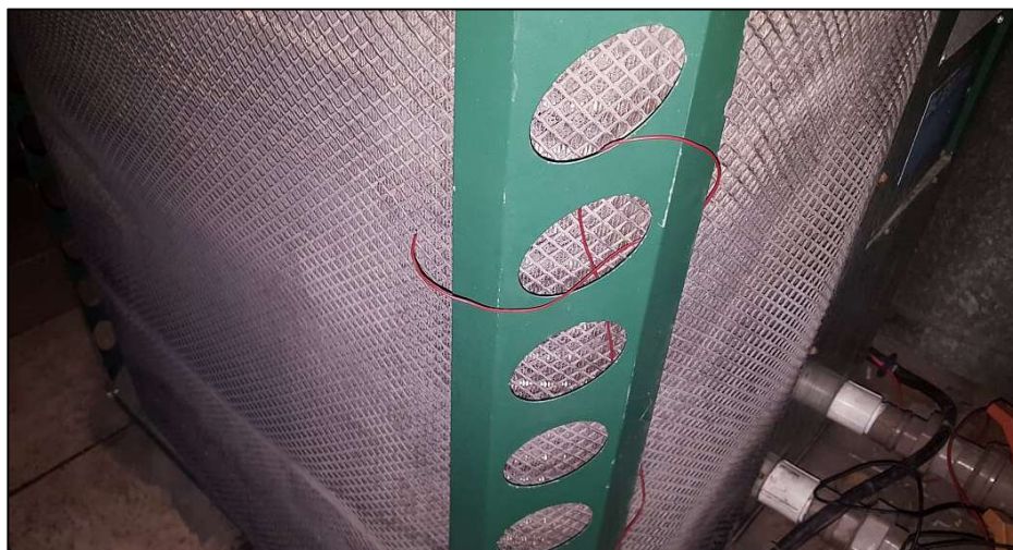
Figura 31 – Instalação do Termopar Tipo J no Entorno da Bomba de Calor nº 2
