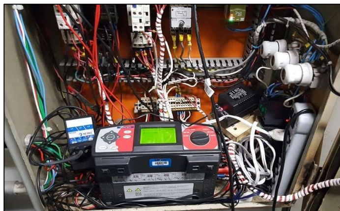
Figura 27 – Analisador de Energia Instalado no Quadro Elétrico da Piscina
