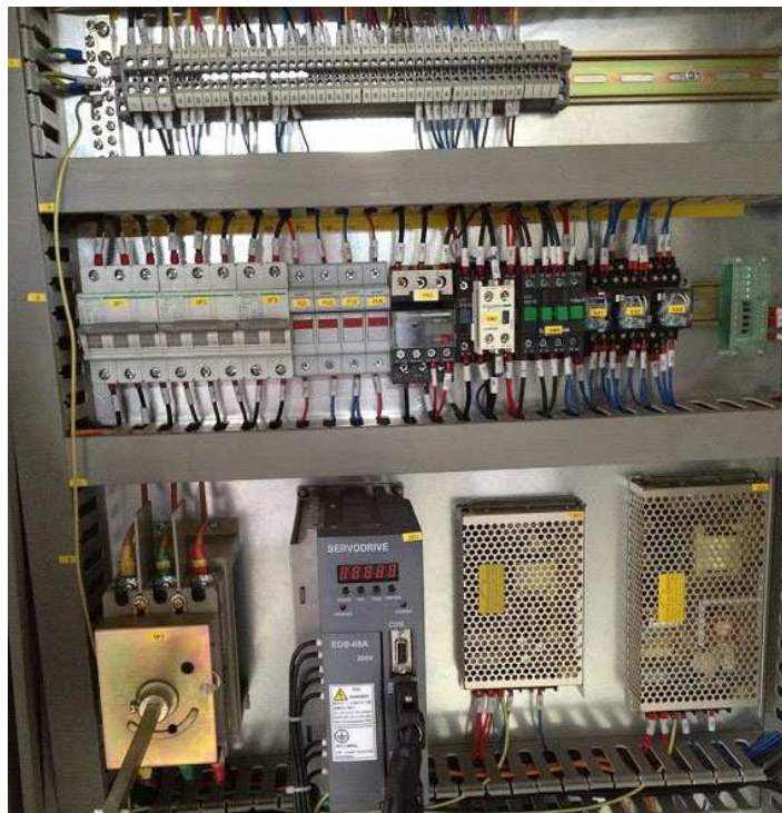
Figura 15 - Exemplo de painel elétrico da dobradeira Fonte: WORLD (2014)
