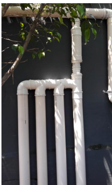
Figura 12 – Ligação do dispositivo de descarte de primeira chuva na tubulação de captação de água de chuva. Fonte: Aatoria própria (2016).
