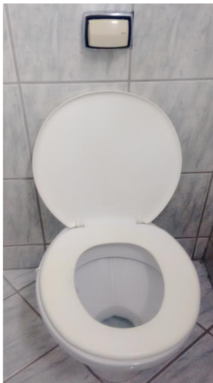
Figura 20 – Descarga válvula hydra.
