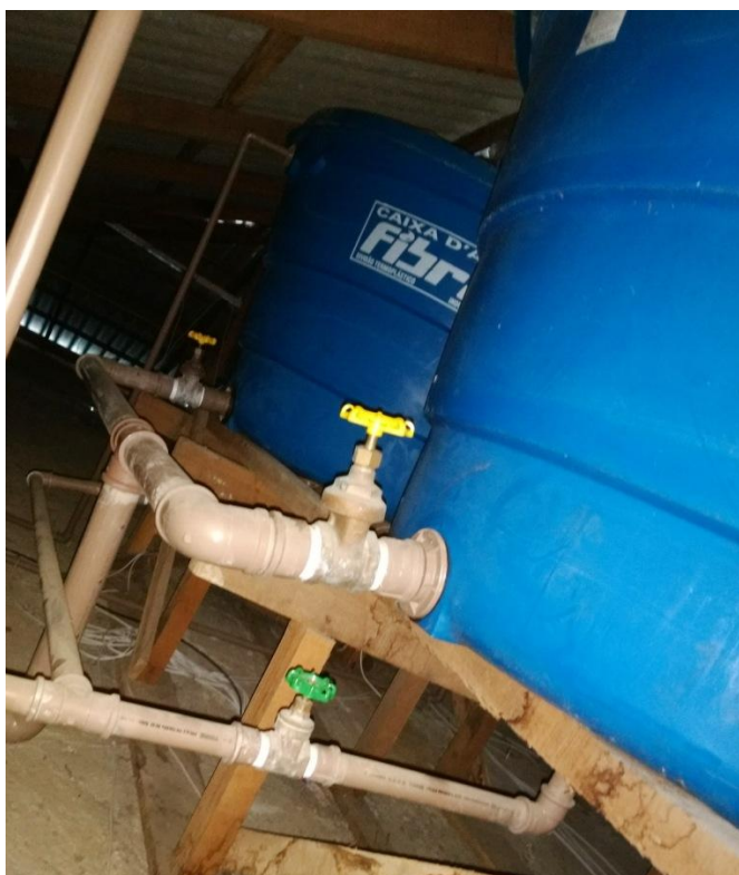
Figura 18 – Ligação entre as caixas d'água Fonte: Autoria própria (2016).
