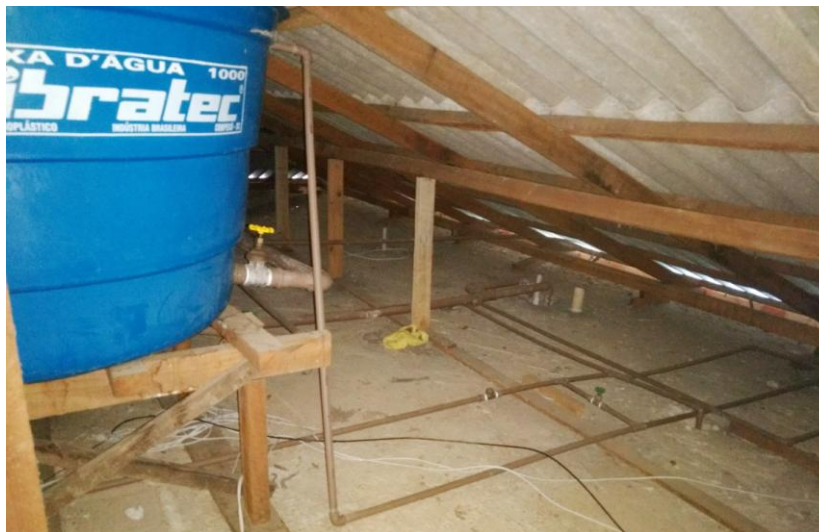
Figura 19 – Tubulações de abastecimento
