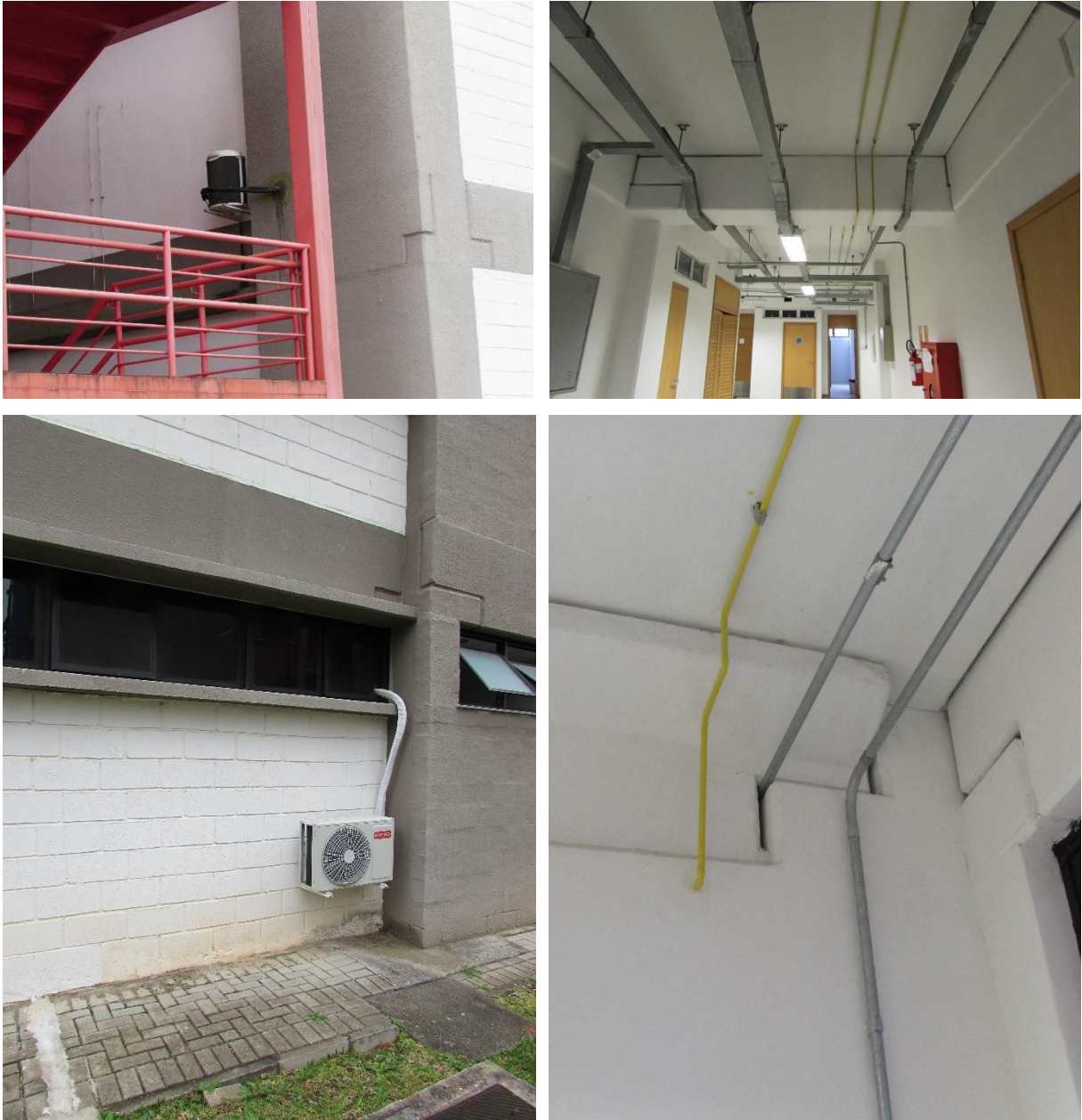
Figura 51 - Adaptações de Tubulações Fonte: Autores (2017)
