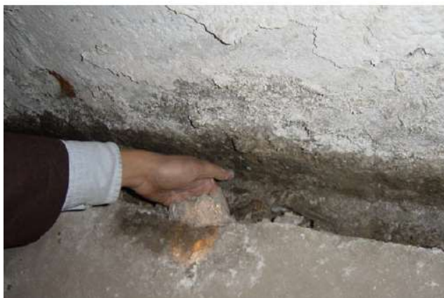
Figura 7 - Deterioração dos canais de drenagem internos à tubulação pelo ataque de sulfatos com formação de taumasita. Concreto desagregado com consistência amolecida Fonte: MA et al. , 2006
