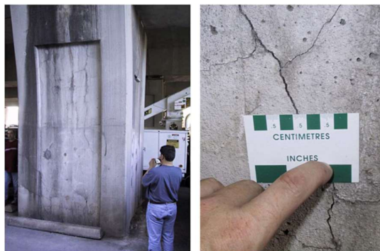
Figura 12 - Aparência de alguns dos pilares de concreto avaliados, com idade de 15 anos Fonte: THOMAS et al. , 2008
