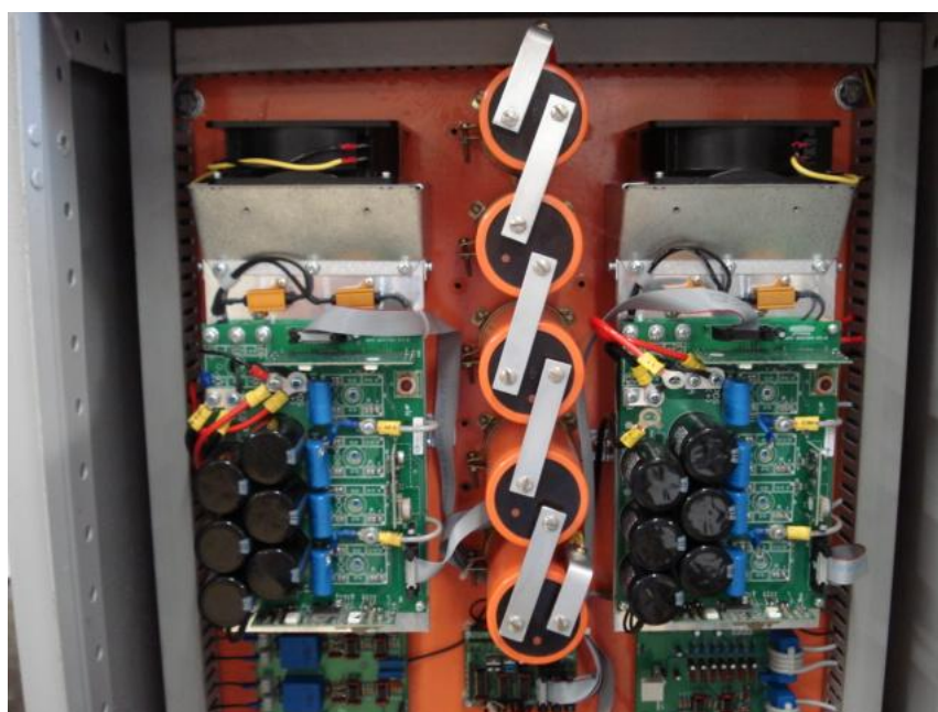
Fig. A.2 – Módulos inversores dos conversores série e paralelo e barramento DC da UPS.
