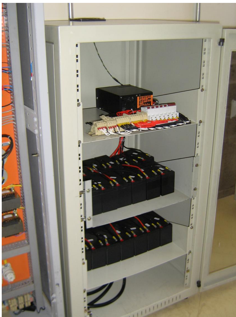
Fig. A.7 – Detalhe do módulo do banco de baterias da UPS.
