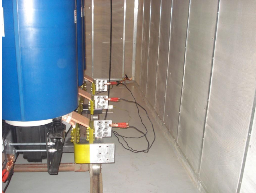
Figura 18 –Alimentação do transformador sob teste.
