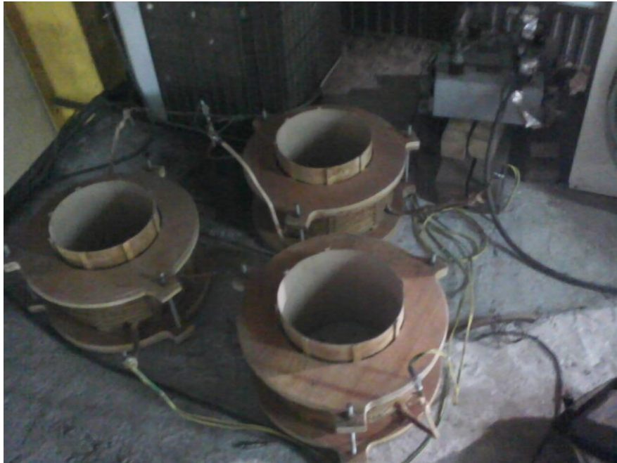
Figura 16 –Filtro passa-baixa instalado.
