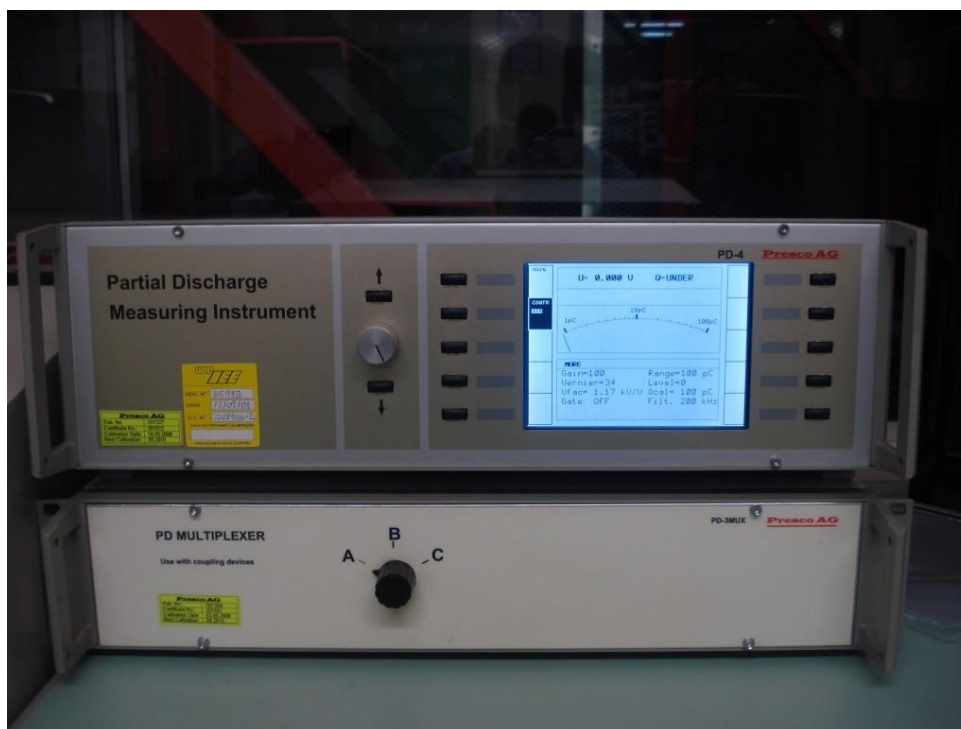
Figura 20 – Equipamento utilizado para medição de descargas parciais nos transformadores.
