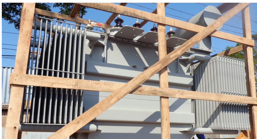
Figura 1 - Transformador imerso em óleo isolante, com potência de 2,5MVA 6,6/0,38 kV
