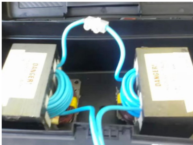
Figura 28 – Conexão Enrolamento Secundário.
