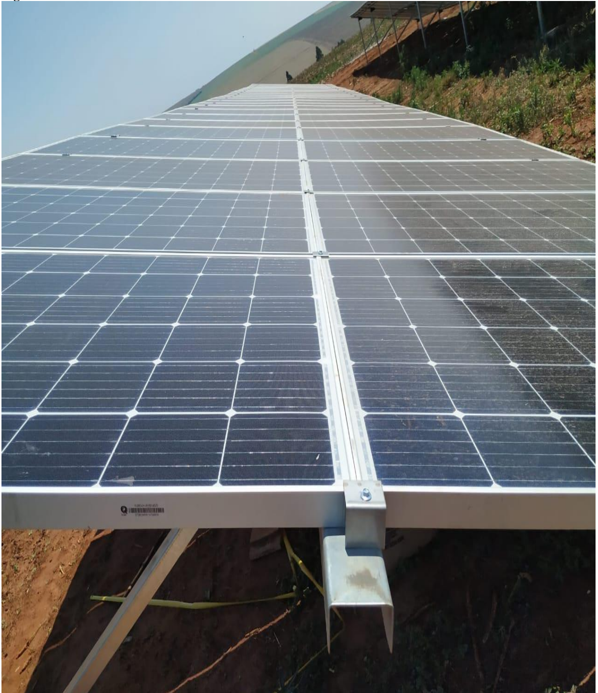
Figura 6 – Placas fotovoltaicas instaladas
