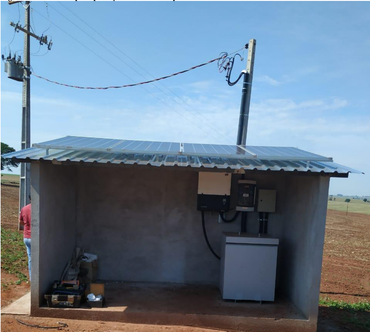
Figura 8 – Estrutura para proteção do inversor e painéis instalados sob o telhado
