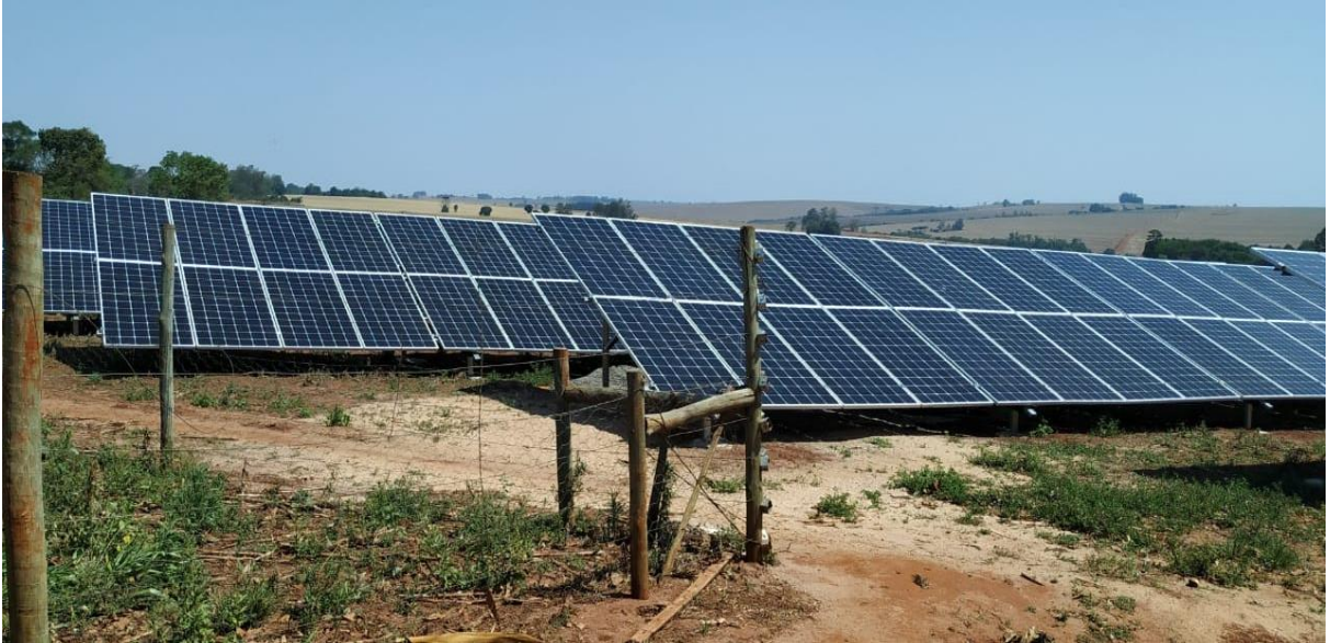
Figura 7 – Placas fotovoltaicas instaladas
