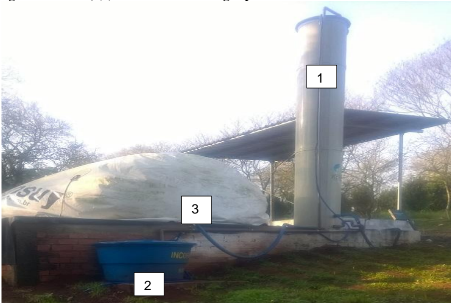
Figura 4 – Sistema de biofiltração e armazenamento de biogás purificado. (1) Biofiltro (2) reservatório de água residuária, (3) reservatório de biogás purificado.
