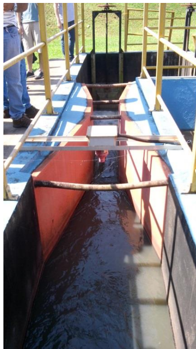
Figura 2. Calha Parshal da ETE Rio do Campo, Campo Mourão – PR.
