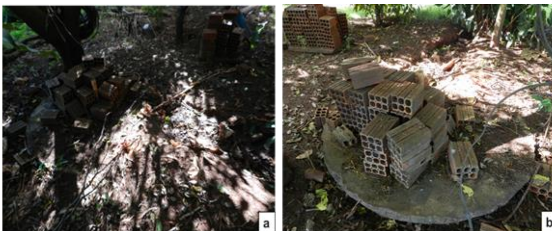
Figura 36 – Lote 110: a) Fossa Séptica b) Fossa Séptica
