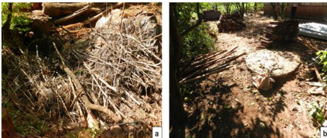
Figura 35 – Lote 108: a) Fossa Séptica b) Fossa Séptica
