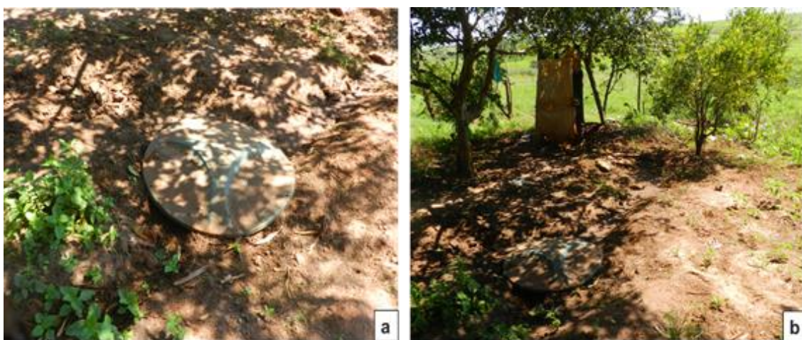
Figura 27 – Lote 101: a) Fossa Negra b) Fossa Negra e Banheiro externo
