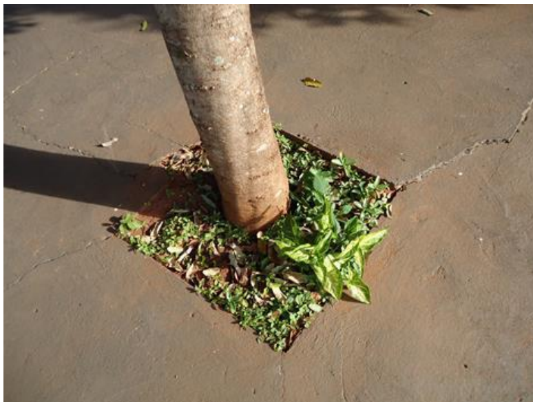
Figura 14 – Licania tomentosa (Benth.) Fritsch (Chrysobalanaceae): dano de grau leve ao calçamento devido à área livre insuficiente na rua Iguaçú em São Tomé, Paraná.
