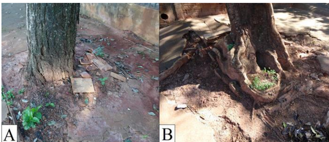
Figura 15 – Handroanthus heptaphyllus Mattos (Bignoniaceae): dano de grau médio ao calçamento (A) na rua Marabá; Delonix regia (Boojer ex Hook.) Raf. (Fabaceae): dano de grau médio ao calçamento pelas raízes superficiais vigorosas (B) na rua São Manoel; em São Tomé, Paraná.
